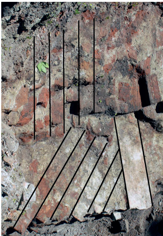
Fotografia 3. Mur czoła bastionu. Podkreślone kierunki układu cegieł. Z prawej strony zdjęcia widoczna pozostałość sięgacza kotwiącego kamienną oblicówkę. Fot. aut.
